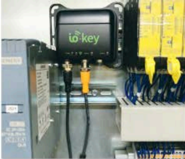
Ein angeschlossener IO-Key im Schaltschrank. (Bild: Autosen)
