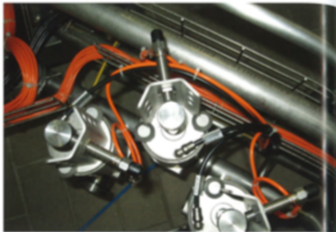
Induktive Sensoren steuern im Produktionsprozess die Ventile der Versorgungsleitungen an
